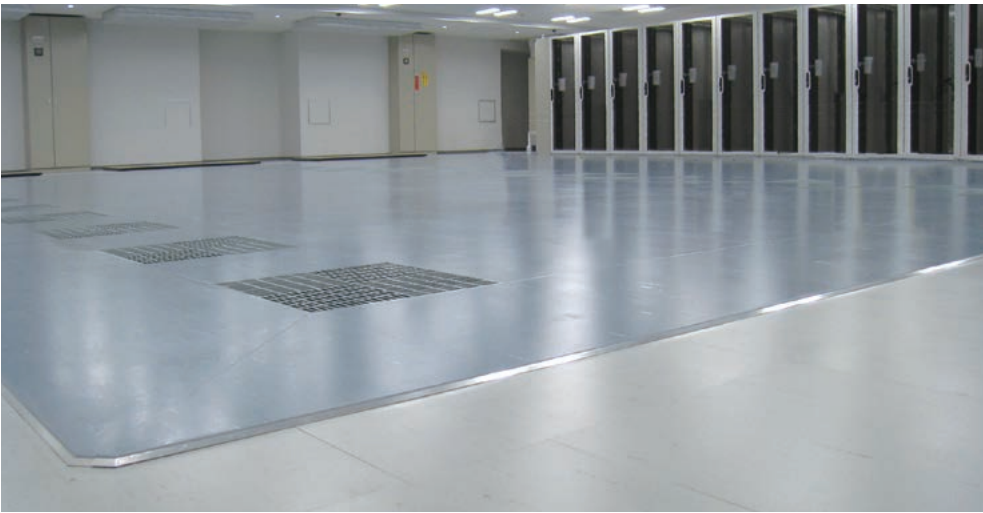
データセンター（大阪府）
