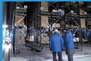
冷凍自動倉庫 (岐阜県)
