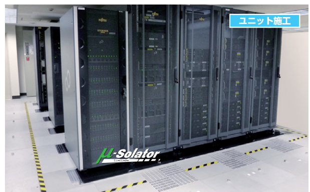
コンピュータサーバラック
