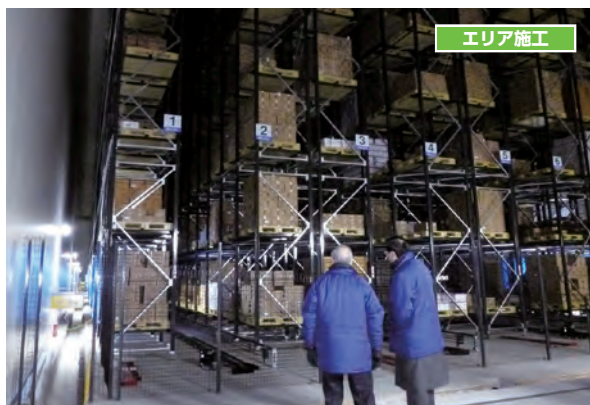
冷凍自動倉庫
